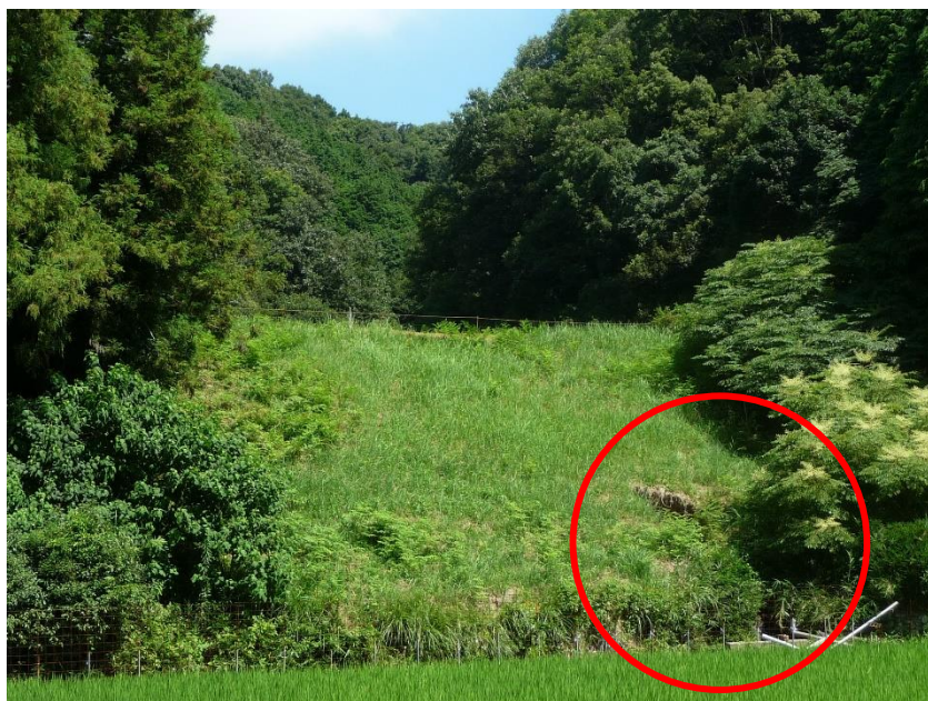
底樋出口から約5m上流側法面が陥没
