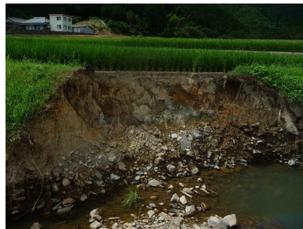
水田畦畔・河川護岸の崩壊
