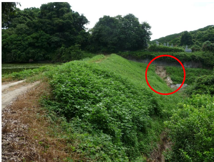
余水吐下流水路の越流による法面崩壊
