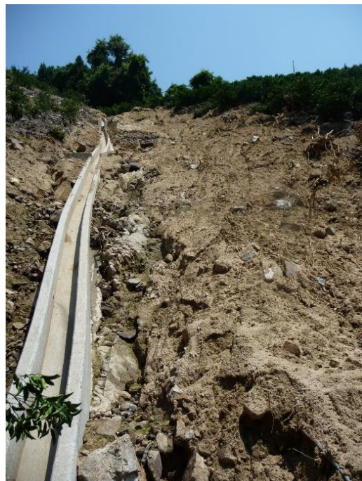
排水路に沿って斜面崩壊
