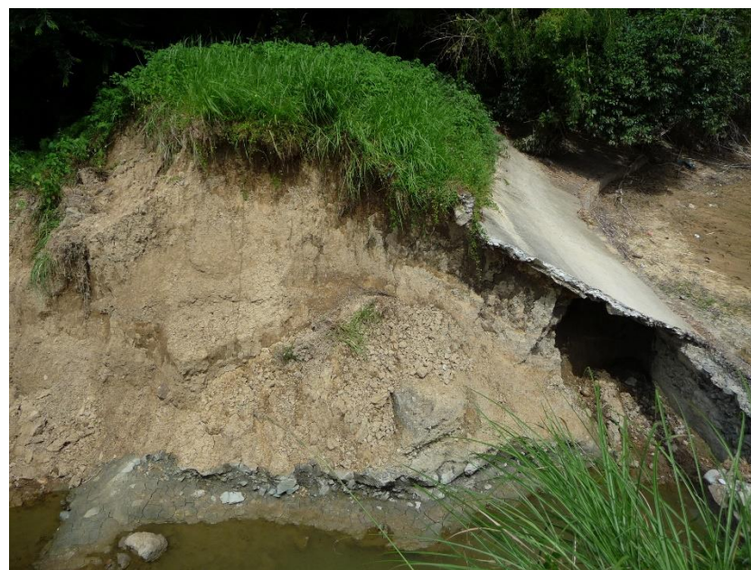
決壊部の堤体断面
