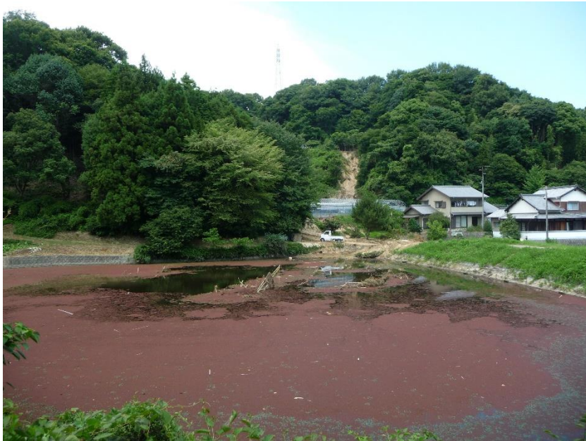
左岸側斜面からため池へ土砂流入
