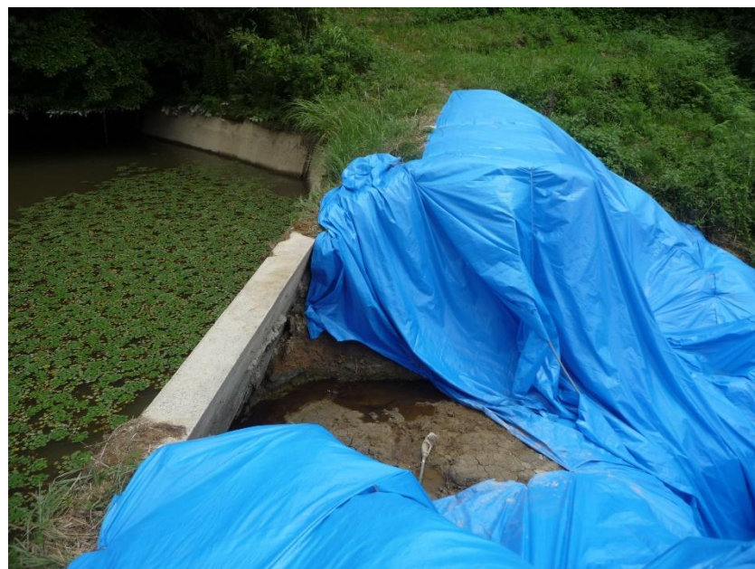
コンクリートより上の部分が損失
