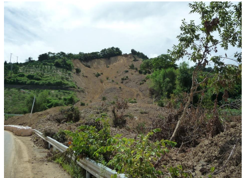
ため池後背地の斜面崩壊
