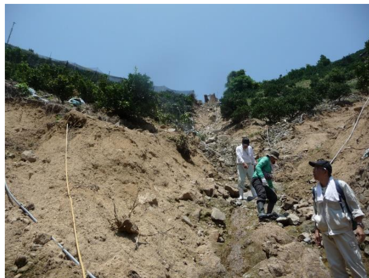
谷部での斜面崩壊
