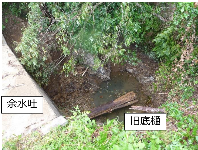
余水吐下流擁壁の崩壊と旧底樋の露出
