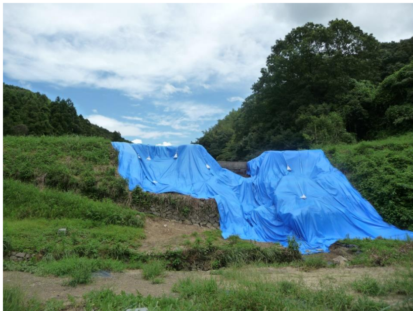
堤体の損傷（底樋より左岸側）
