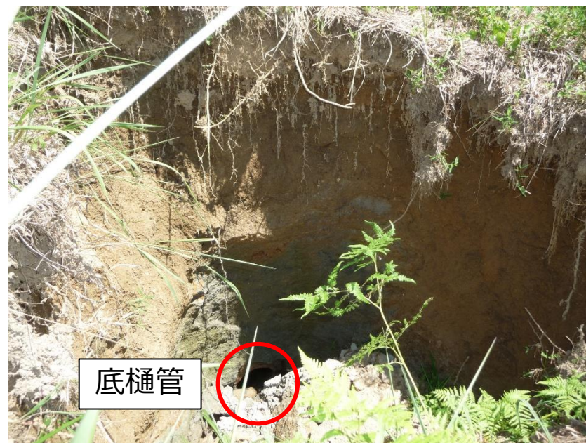
陥没した部分の様子
