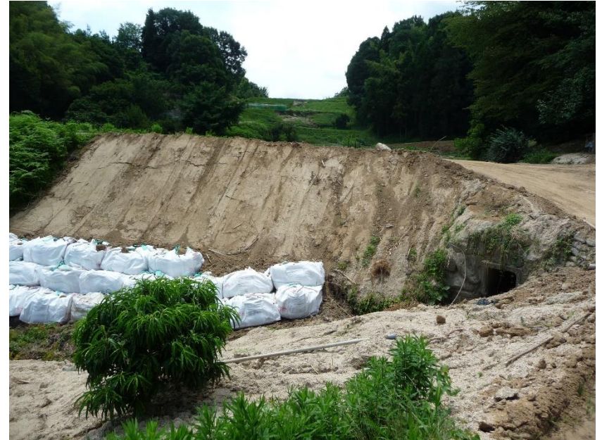
流入土砂により堤体損傷（改修済）
