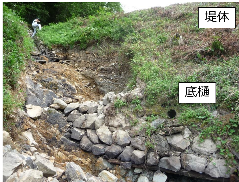
余水吐の崩壊により堤体にも損傷
