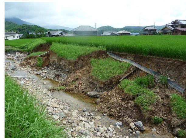
水田畦畔・河川護岸の崩壊
