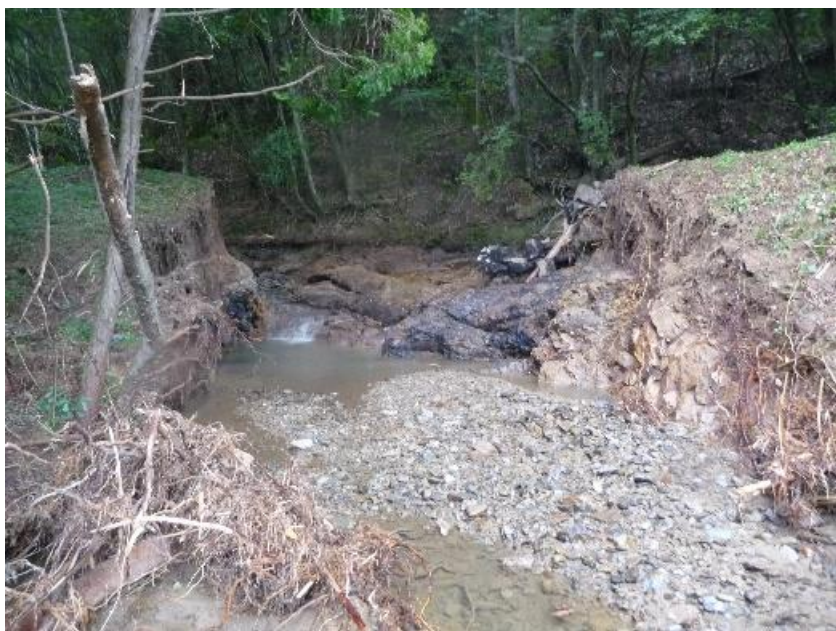
ため池流入部の崩壊と土砂流入
