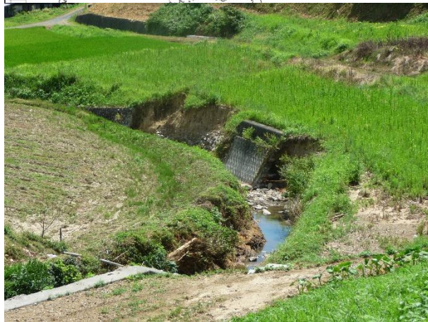
河川護岸の崩壊
