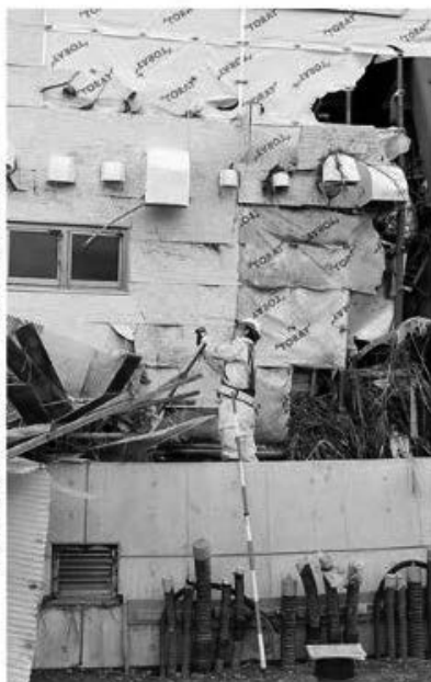
建設中の野村学校給食センターの浸水被害を調べる森雄教授 11月10日午後6時5分ごろ、西予市野村町野村
