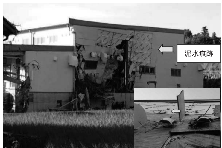
写真 6.1.1-4 せいよ東学校給食センター被害状況
