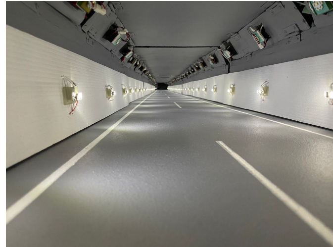
トンネル低位置照明
