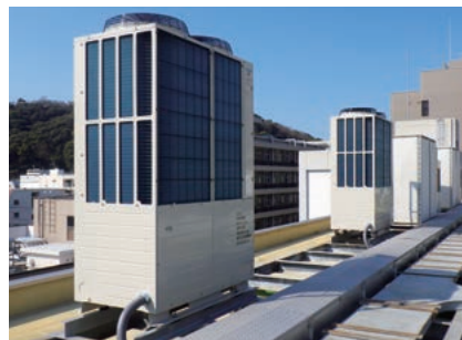
高効率空調設備への更新
